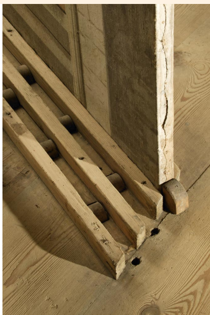
DETAIL DRÁŽEK S KOLEČKY V PODLAZE PRO UMÍSTĚNÍ BOČNÍCH KULIS. DO OTVORŮ PŘED KULISY BYLY ZASTŘENY DŘEVĚNÉ KOLÍKY,
